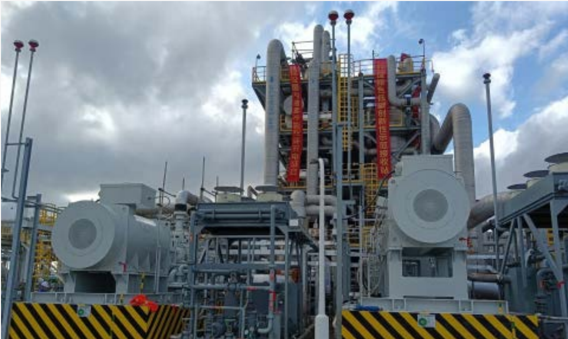
国内首套 LNG 冷能双环发电装置
