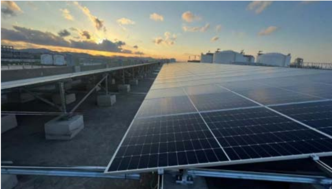
舟山接收站建设的光伏车棚
